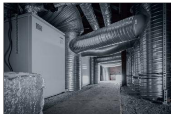
Die Wärmepumpenanlagen beider Gebäude bestehen aus je drei Luft-Wasser-Wärmepumpen vom Typ Stiebel Eltron WPL 24i, konfiguriert als Kaskadenschaltung mit Laufzeitabgleich, sowie drei 700l-Pufferspeichern.
