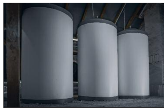
Die drei 700l-Pufferspeicher sind über ein Zwei-Leiter-System mit den Stiebel Eltron-Wohnungsstationen verbunden, die Heizwärmeverteilung und dezentrale Trinkwarmwasserbereitung übernehmen.
